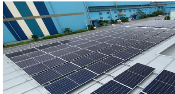
태양광 발전 설치 구축 후
